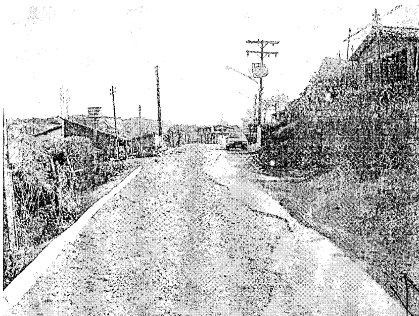
Condição precária da pavimentação
